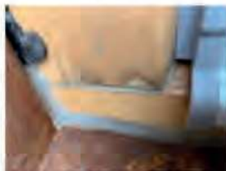
Schadensbild von einem Fenster mit V-Fugensiegel
